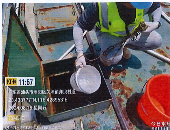
施工 5 标 TBM 隧道开端生活污水
